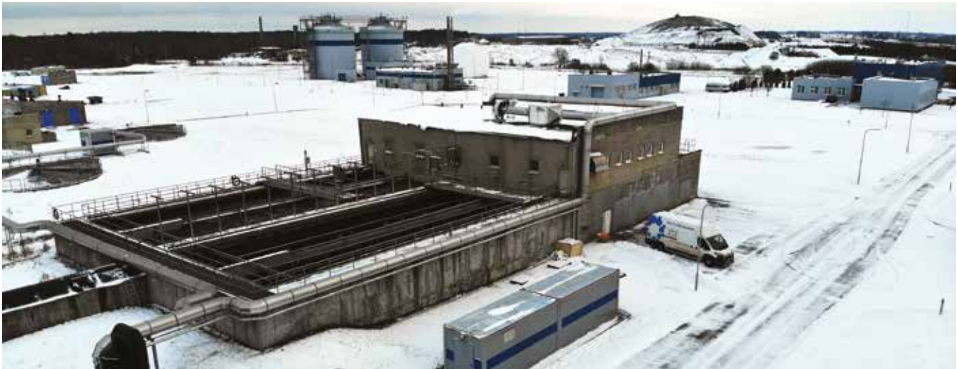
Pav. AB „Klaipėdos vanduo“ nuotekų valyklos smėliagaudė, grotų pastatas ir sumontuota ozonavimo įranga
