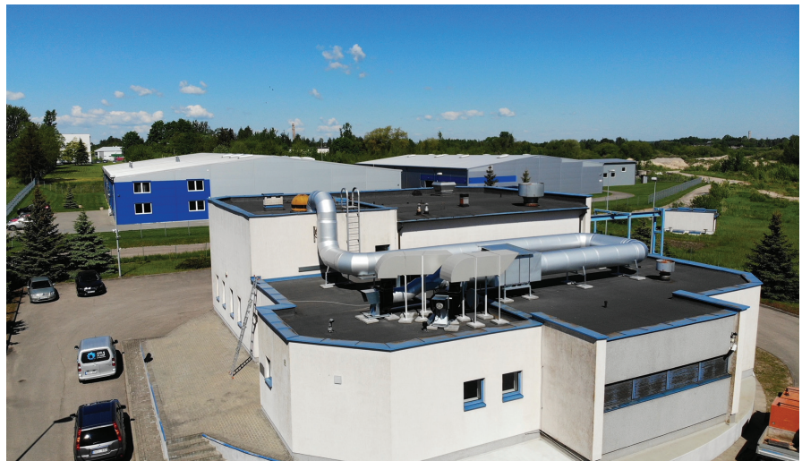
Pav. Pagrindinėje nuotekų perpumpavimo siurblinėje įrengus modernią kvapų šalinimo sistemą, oro tarša neutralizuojama iki 94 proc. ir dabar nebepasiekia aplinkinių gyvenamųjų teritorijų
