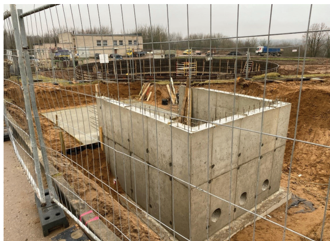
3 pav. Betonuojamas pramoninių nuotekų priėmimo mazgas
