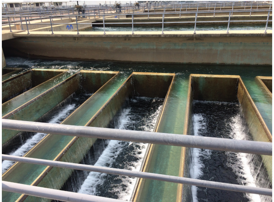
2 pav. Vandens filtrai Bangken vandens ruošykloje (Tailandas)
