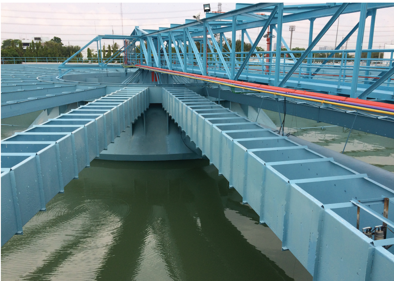
1 pav. Vandens skaidrintuvai Bangkhen vandens ruošykloje (Tailandas)
