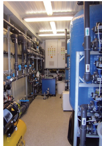
2 pav. Karklės vandens ruošyklos įrenginiai
