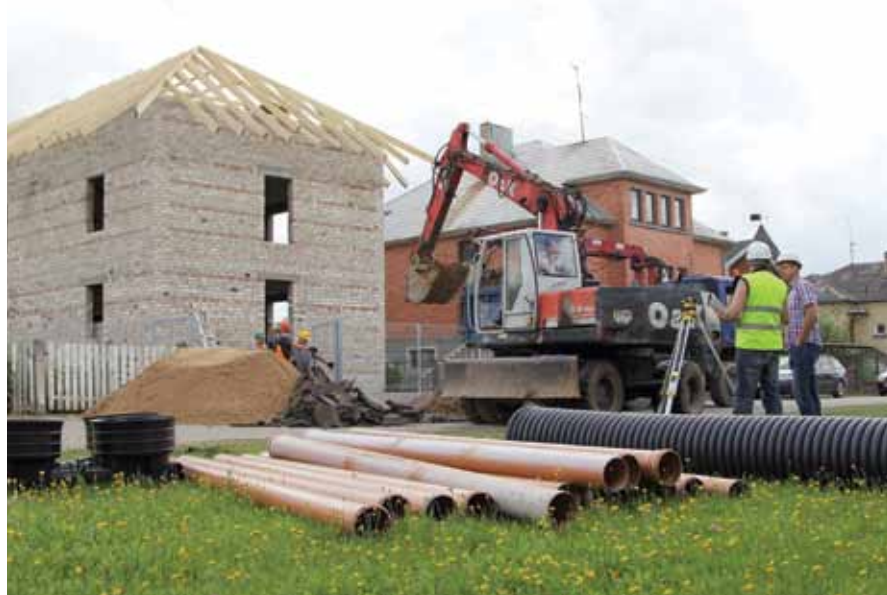
Pav. Šiauliuose tiesiami vandentiekio ir (ar) nuotekų šalinimo tinklai iki sklypų ribos pagal gyventojų prašymus. Bendrovė rengia supaprastintus statinio projektus ir finansuoja statybos darbus. Tinklų statybos darbai Zemaitės gatvėje
