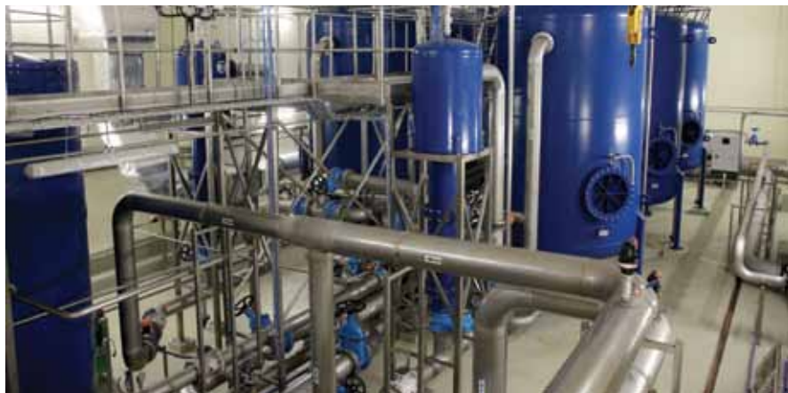
3 pav. Modernūs vandens gerinimo įrenginiai Lepšių vandenvietėje
