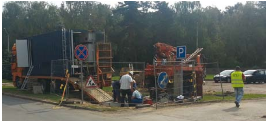
1 pav. Į „Compact Pipe“ vamzdį tiekiamas aukštos temperatūros sotusis garas
