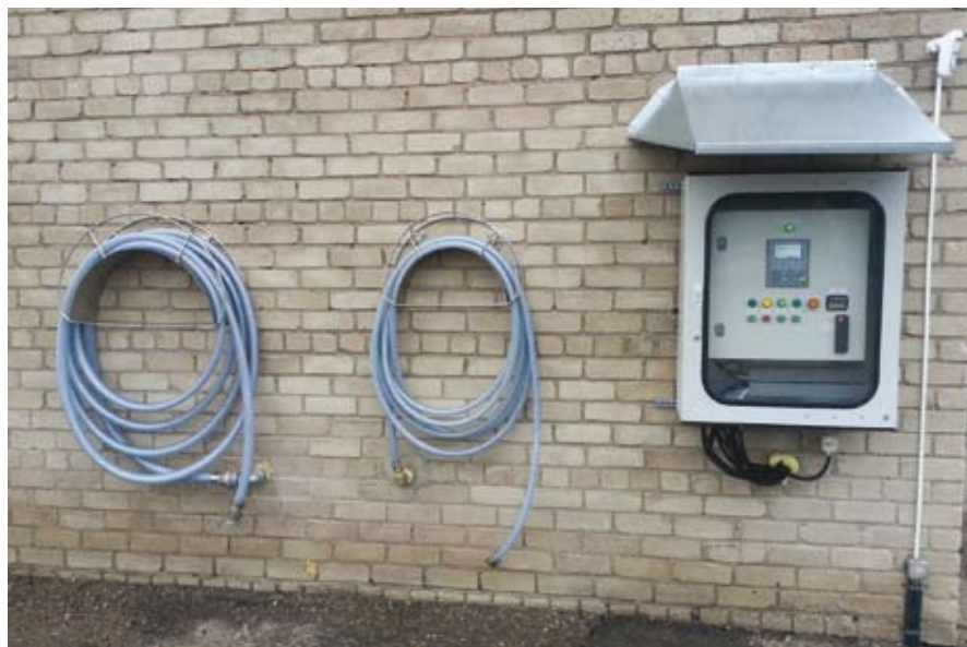
1 pav. Automatinė vandens stotelė
