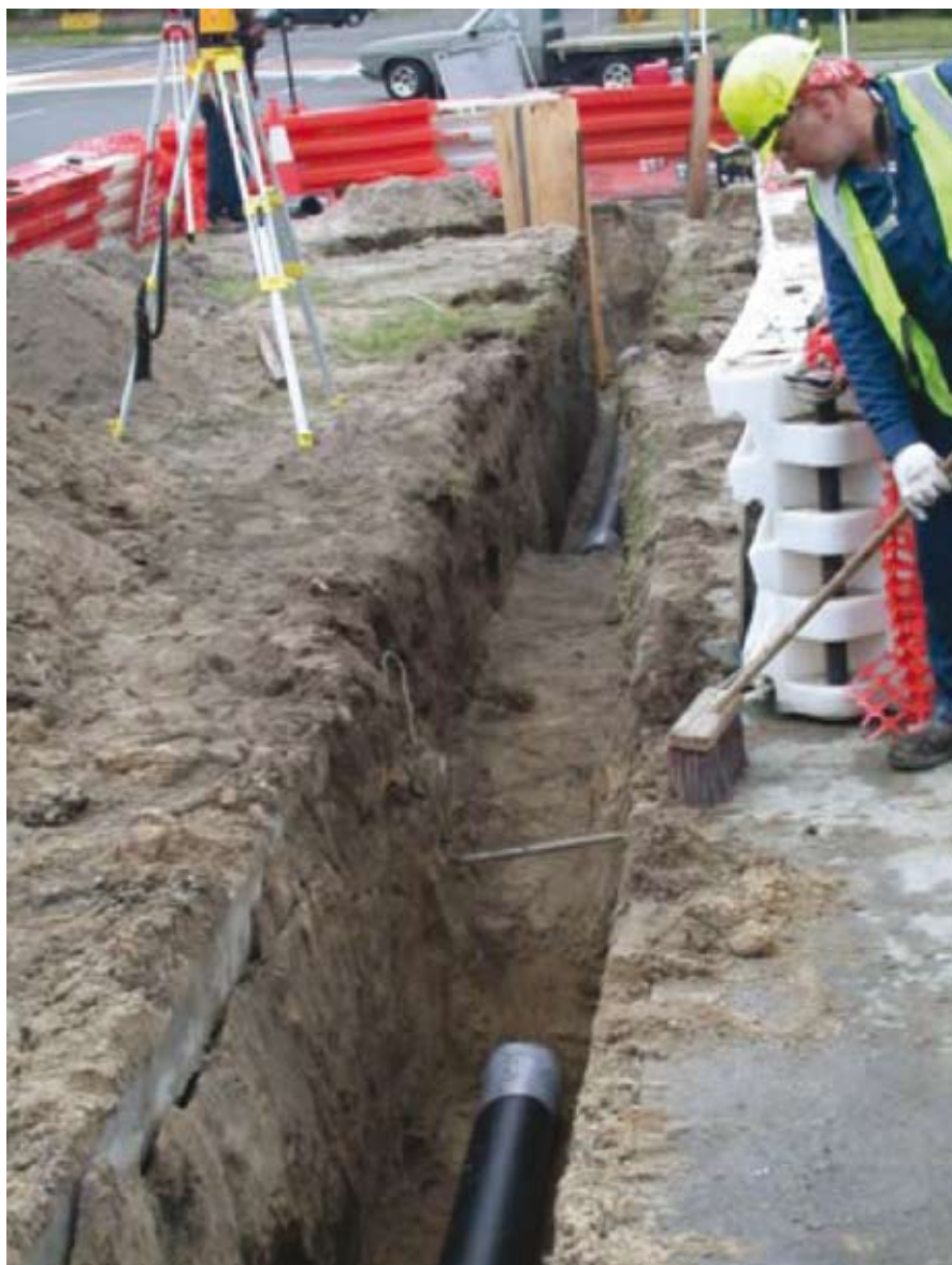
7 pav. Vakuuminiai nuotekų surinkimo vamzdžiai
