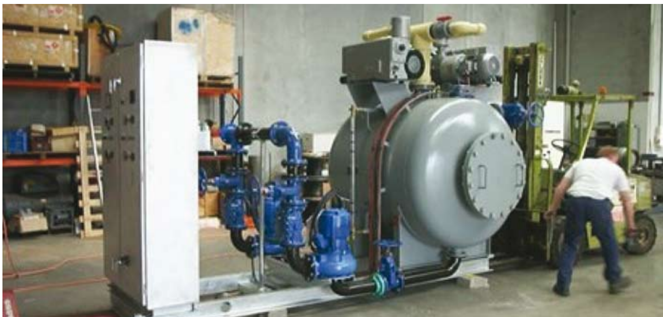
6 pav. Vakuuminė stotis
