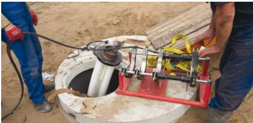
3 pav. Prijungiama garų įranga, kurios dėka vamzdis išsiplės ir priglis prie buvusio vamzdyno sienelių
