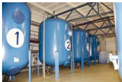
2 pav. „Birutės“ vandenvietėje įrengti aštuoni nugeležinimo filtrai per parą gali išvalyti 16,5 tūkst. m 3 iš dviejų šimtų metrų gylio gręžinių išgaunamo vandens. Po rekonstrukcijos panašūs filtrai veiks ir Lepšių vandenvietėje
