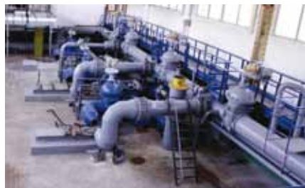
1 pav. Šioje patalpoje rekonstrukcijos metu bus pastatyti nugeležinimo filtrai
