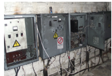
5 pav. Senieji gręžinių valdymo skydai po gaisro
