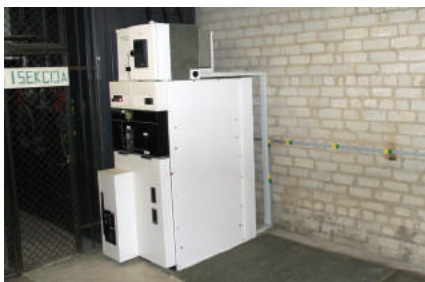
1 pav. 10 kV skirstykla po rekonstrukcijos
