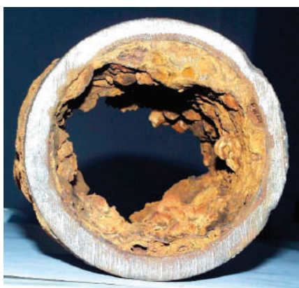
4 pav. Tipiška seno vandens tiekimo vamzdžio būklė: nuosėdos, inkrustacija, sumažėjusio stiprumo vietos, pvz. plyšiai ir korozija
