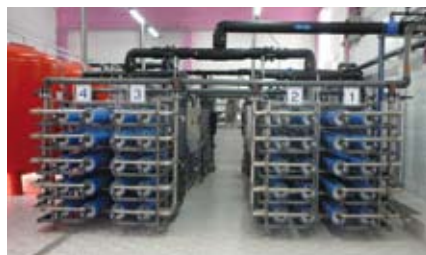
3 pav. Atvirkštinio osmoso įrenginys Kretingos vandenvietėje, apdorojantis maždaug 1800 kubinių metrų požeminio vandens per parą
