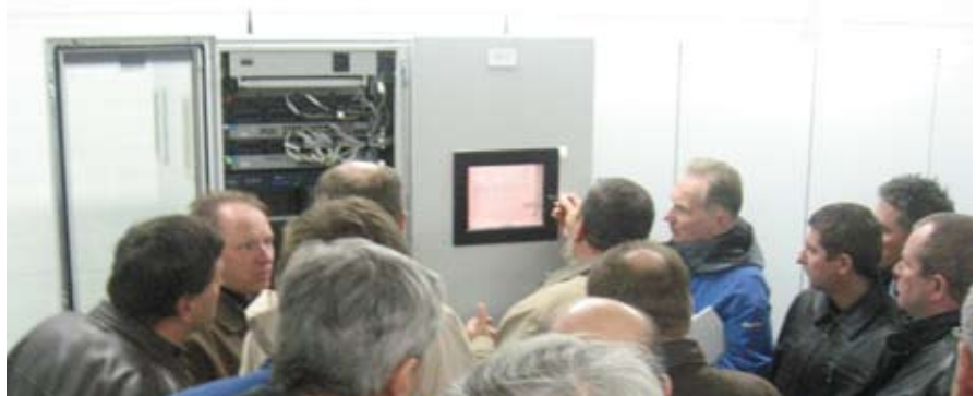
3 pav. Centrinų SCADA valdymo įrenginių ir serverių ūkio apžiūra
