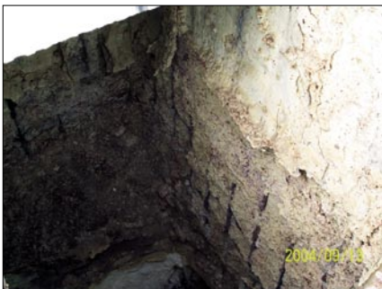
1 pav. Biogeninės sieros rūgšties kondensato sukelta betono korozija
