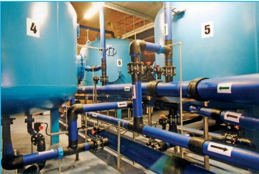
Modernizuota Tupatiškių vandenvietė, vandens filtrai
