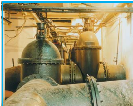
Viršuliškių trečiojo kėlimo vandentiekio stotis prieš modernizaciją
