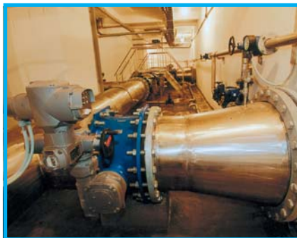
Viršuliškių trečiojo kėlimo vandentiekio stotis po modernizacijos
