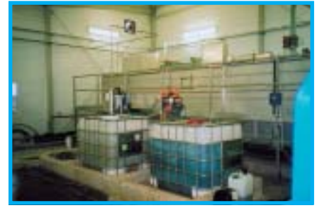
Chemikalų konteineriai, dozavimo įranga ir reakcijos talpa
