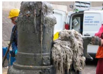
10 pav. Įprastinės užkemšiančios medžiagos, pašalintos iš siurblio (šaltinis: „Scottish Water“)
