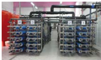
3 pav. Atvirkštinio osmoso įrenginys Kretingos vandenvietėje, apdorojantis maždaug 1800 kubinių metrų požeminio vandens per parą
