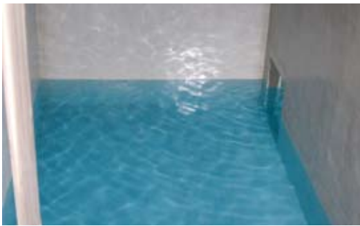
1 pav. Geriamojo vandens rezervuaras
