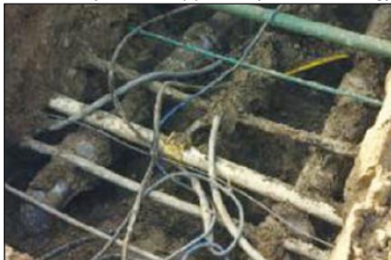
1 pav. Požeminės komunikacijos
